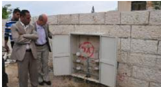
Compteur d'eau du nouveau réseau d'Aqabat Jaber (Palestine) ©Ville de Besançon
